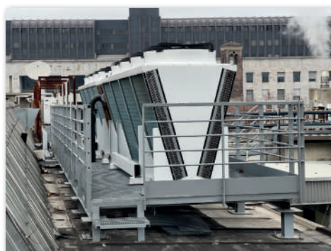
CARPENTERIE DI SOSTEGNO Per pompe di calore - ventilanti
